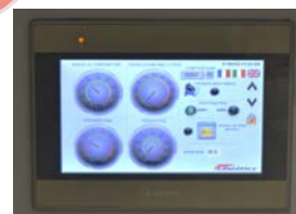
QUADRO DI CONTROLLO CON DISPLAY HMI SU LINEA DHV
